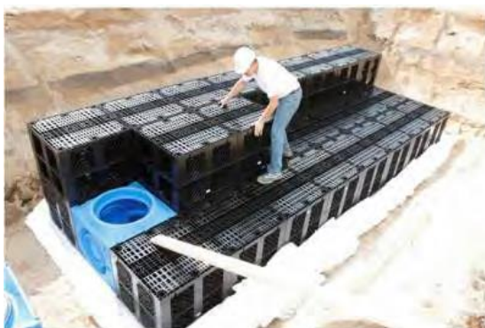
Underjordiskt dagvattenmagasin med kassetter
